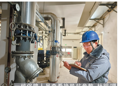
一线保障 人员查看换热站参数。杜明/摄
