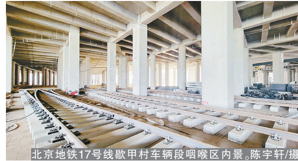
北京地铁17号线歌甲村车辆段咽喉区内景。陈宇轩/摄
