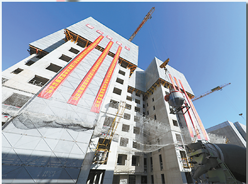
海淀区宝山村回迁安置房项目二标段主体结构封顶。秦碧霞/摄
