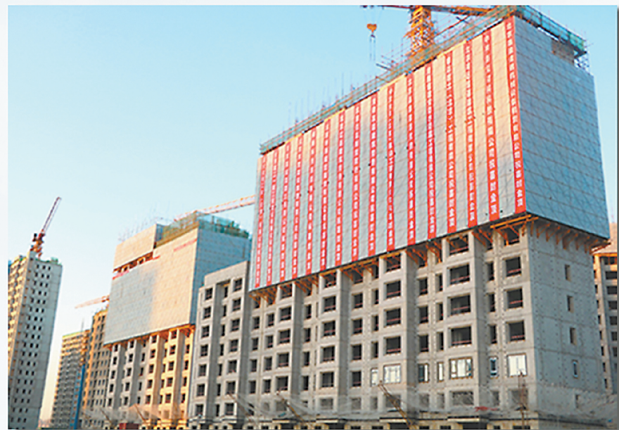
朝阳区王四营L02、05地块住宅及幼儿园工程主体结构全面封顶。尹雯雯/摄
