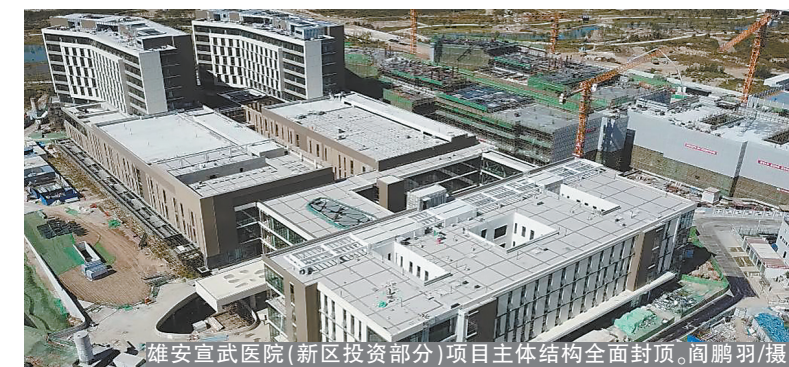
雄安宣武医院(新区投资部分)项目主体结构全面封顶。阎鹏羽/摄
