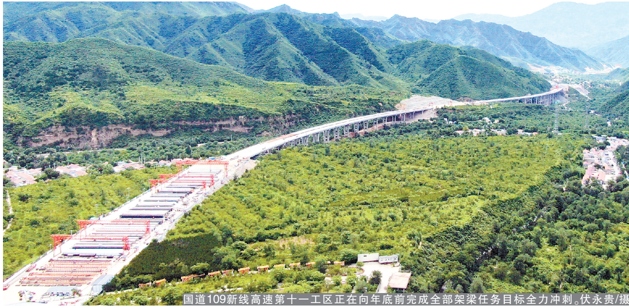
国道109新线高速第十一工区正在向年底前完成全部架梁任务目标全力冲刺。伏永贵/摄
