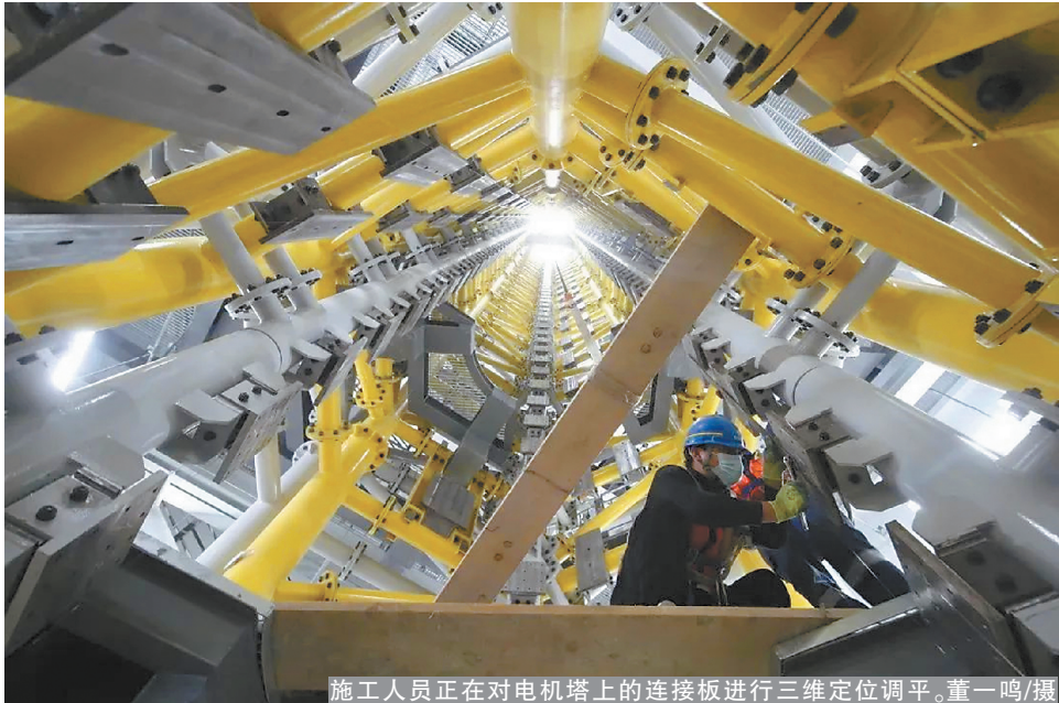
施工人员正在对电机塔上的连接板进行三维定位调平。董一鸣/摄
