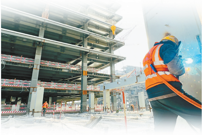
中关村东升科技园二期项目施工人员正在进行钢结构施工。关旭/摄
