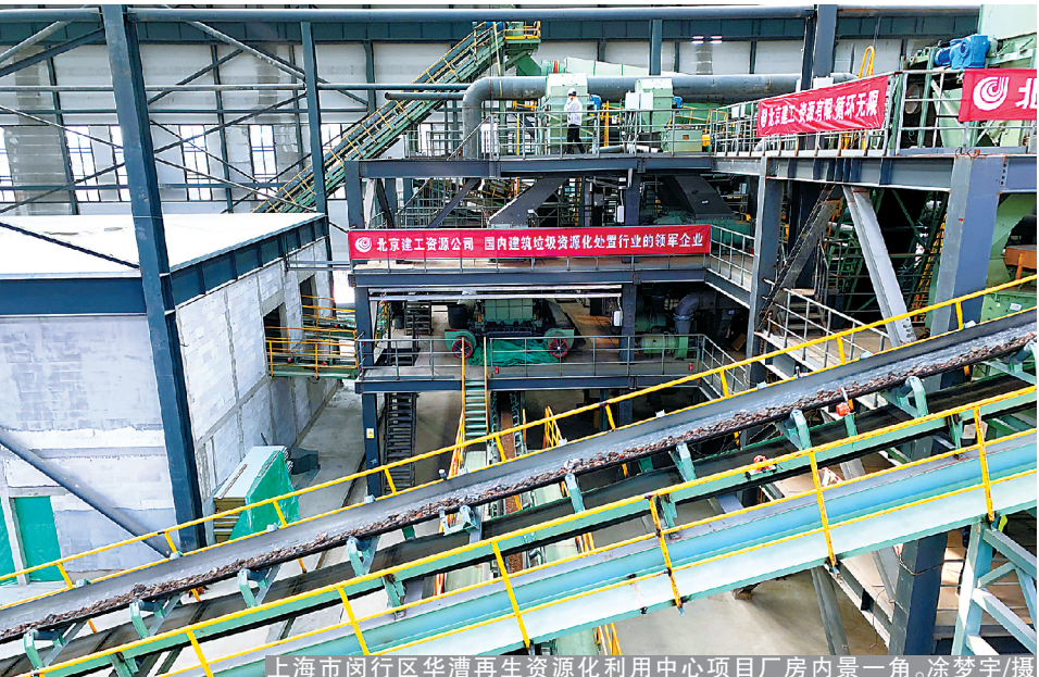
上海市闵行区华漕再生资源化利用中心项目厂房内景一角。涂梦宇/摄
