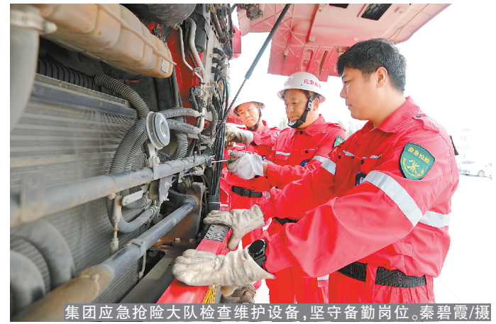
集团应急抢险大队检查维护设备,坚守备勤岗位。秦碧霞/摄
