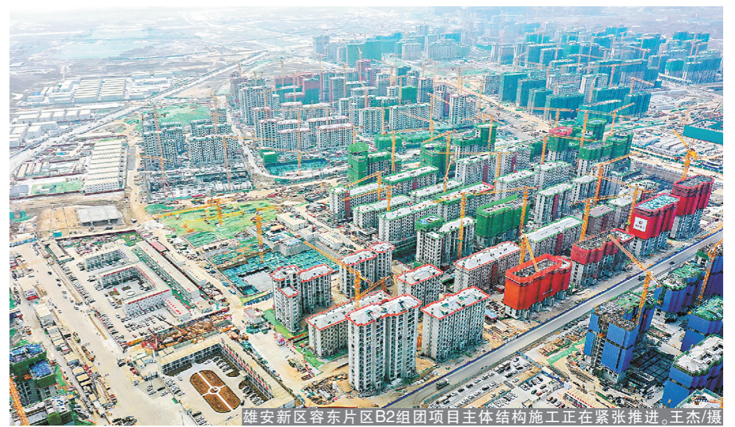
雄安新区容东片区B2组团项目主体结构施工正在紧张推进。王杰/摄
