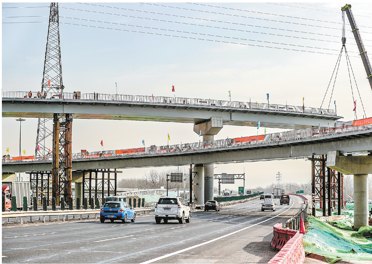
近日,市政集团承建的北京通州环球影城主题公园重点交通配套工程——京哈项目立交段工程桥梁主体结构顺利完工,匝道南北贯通。
