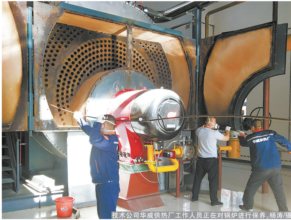
技术公司华威供热厂工作人员正在对锅炉进行保养。杨涛/摄
