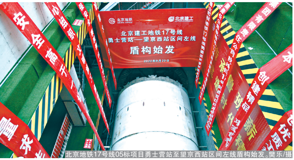
北京地铁17号线05标项目勇士营站至望京西站区间左线盾构始发。樊乐/摄
