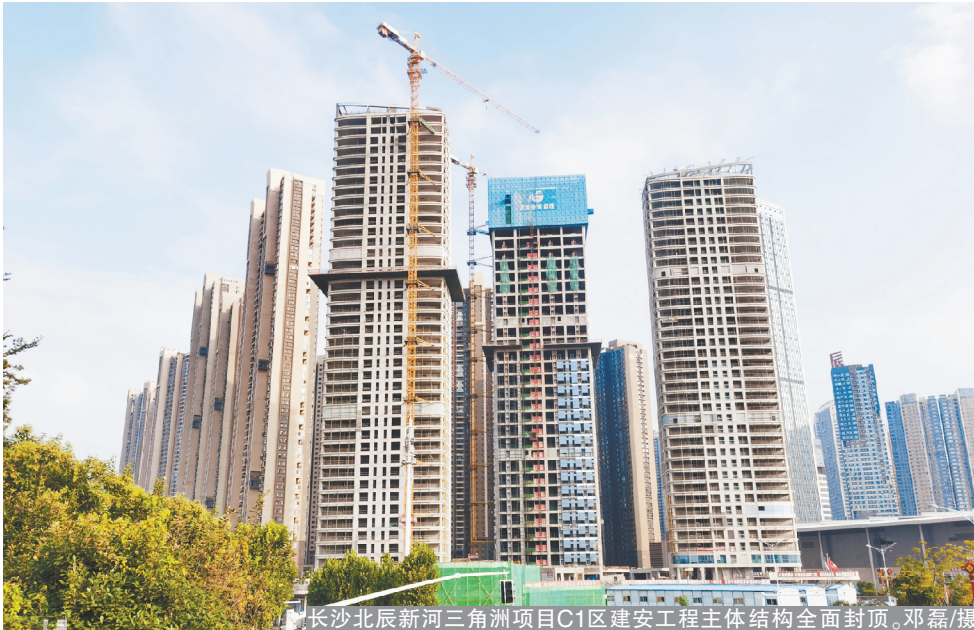
长沙北辰新河三角洲项目C1区建安工程主体结构全面封顶。邓磊/摄
