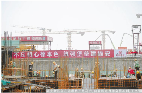
自顺利完成“6.30”土护降施工节点后，项目部立即进入工程桩基阶段，在做好疫情防控工作的同时，提出“发扬劳模精神，永争第一，决胜‘9.10’”的劳动竞赛口号。面对三大建筑中体量最大的一标段，工程桩基施工既要保证安全、质量、进度可控，又要克服疫情影响和汛期降雨的安全风险。
