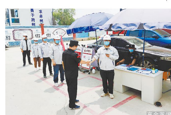
通州文旅区地下综合管廊项目实施全封闭管理,“北京健康宝”查验通行、测温登记、限流控距等疫情防控工作,落实不聚集、不聚餐等疫情防控要求,坚决阻断疫情传播渠道,为项目施工生产顺利进行营造了安全环境。
