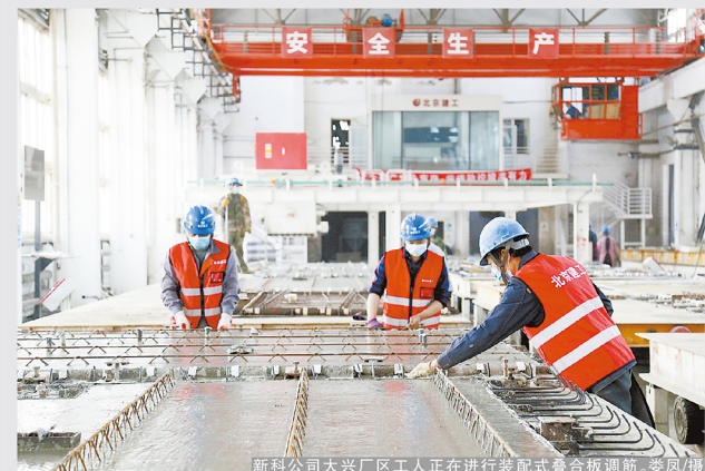
新材公司大兴厂区工人正在进行装配式叠合板调筋。 姜凤旗
