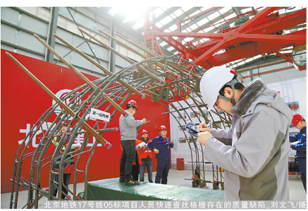
北京地铁17号线05标项目人员检查音柱格棚存在的原质量缺陷。刘文飞/摄
